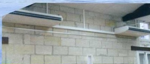
Mise en conformité du chauffage de la salle des fêtes Pose de deux pompes à chaleur
