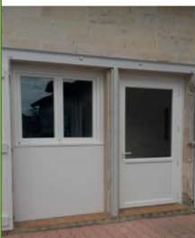
Nouvelle porte et fenêtre de la cuisine de la salle des fêtes
